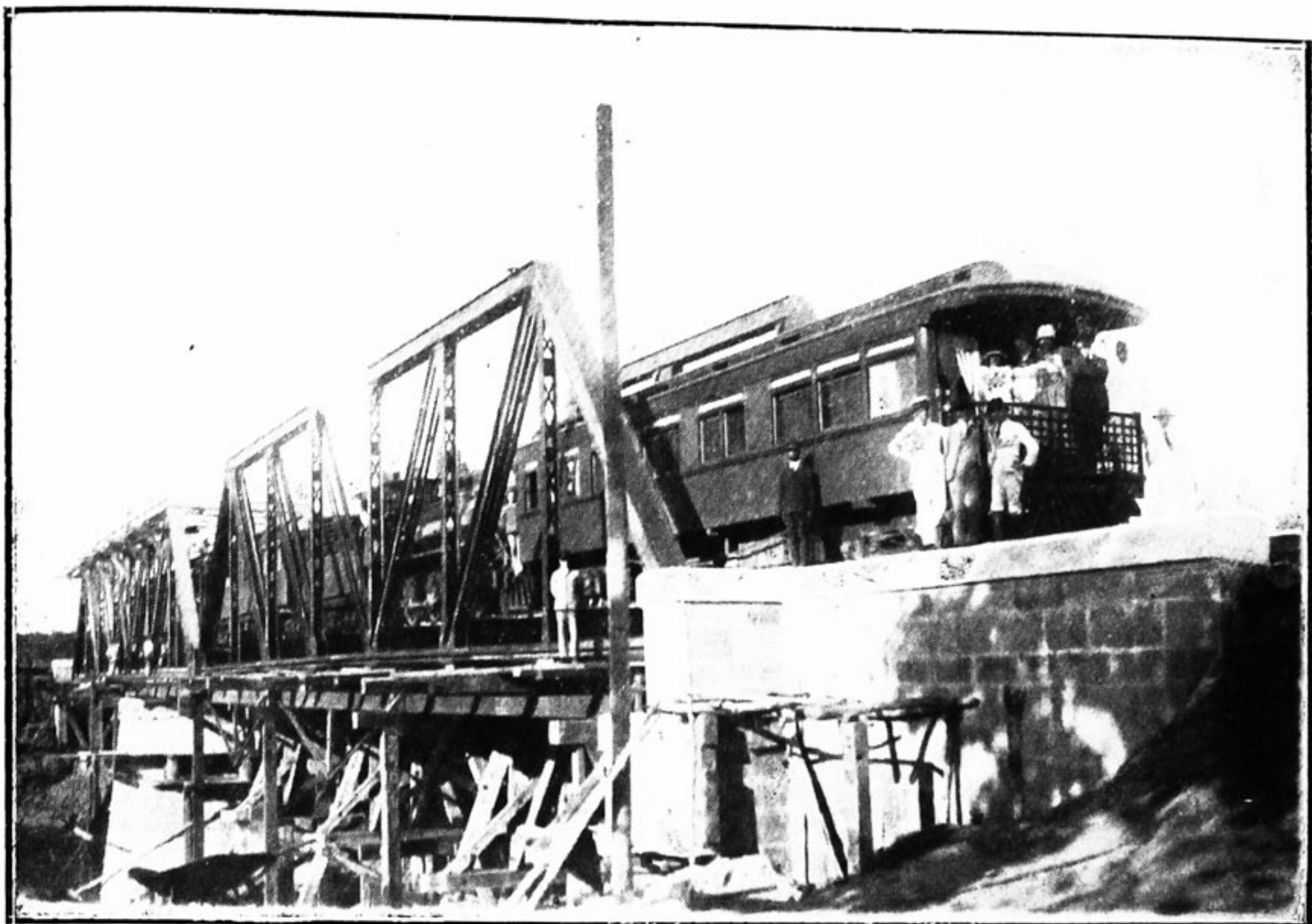
Ponte definitiva do Correntes, em phase de montagem sem interrupção do trafego.
